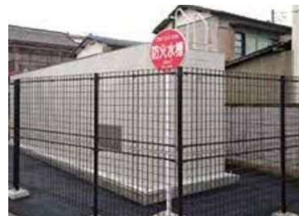
地上設置型（茨城県結城市）
