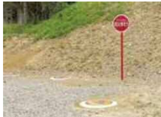
愛知県設楽町 消火栓が無く、コストとのバランスを 考慮した限られた場所への設置。
